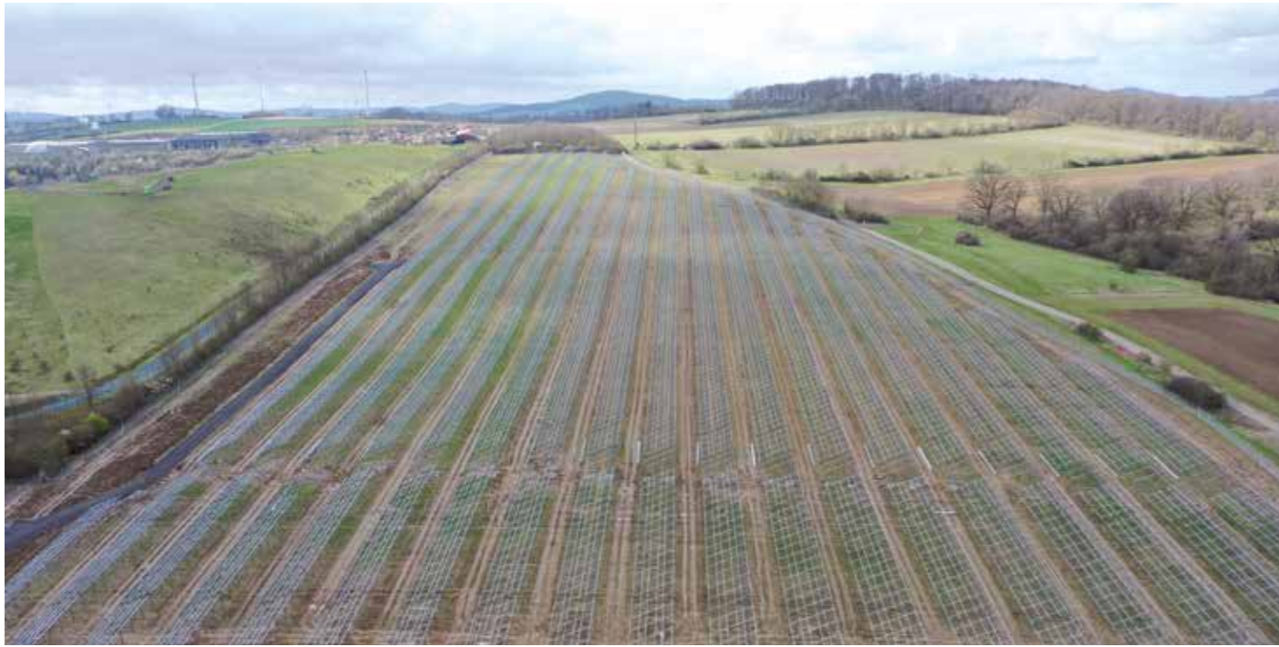
Eine Photovoltaik-Anlage entsteht im Frühjahr 2024 in Deiderode auf von der Klosterkammer verpachteten Flächen. Foto: Landpixel
